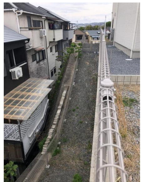
写真 2-6 擁壁間に挟まれ管理困難な共有地（1-10 街区）注 2-1)
