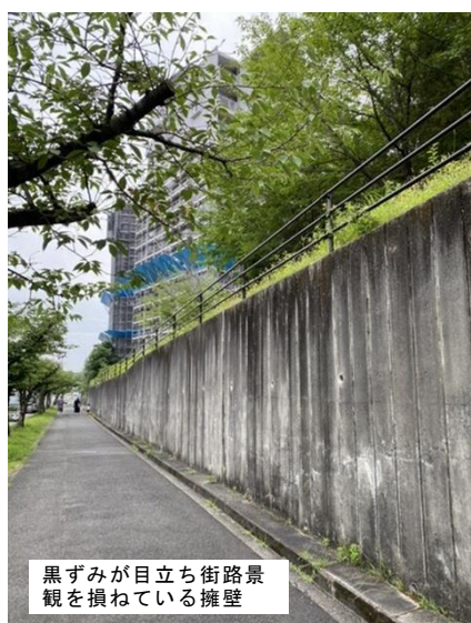
写真 3-3 沿道景観を損ねる擁壁 (3-5 街区) 注 3-1)
